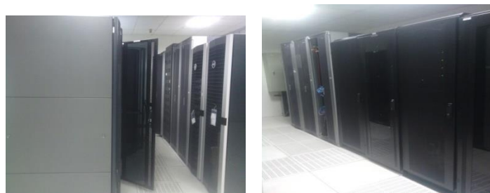
Gambar 9. Hot Isle Dan Cold Isle
